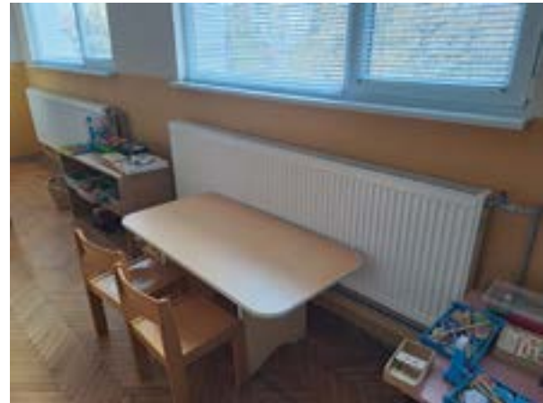
Подменената отоплителна инсталация в ДЯ „Здравец“
